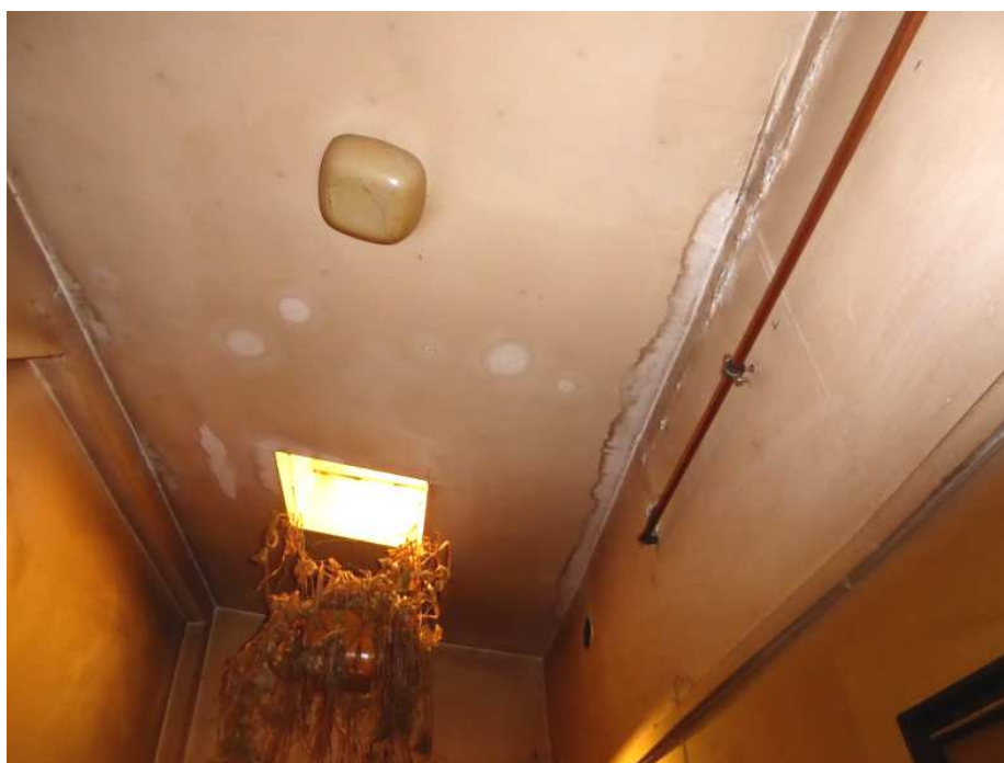
Rys. 4. Intensywny zaciek w mieszkaniu na poddaszu na styku ściany i sufitu lokalne zacieki na suficie
