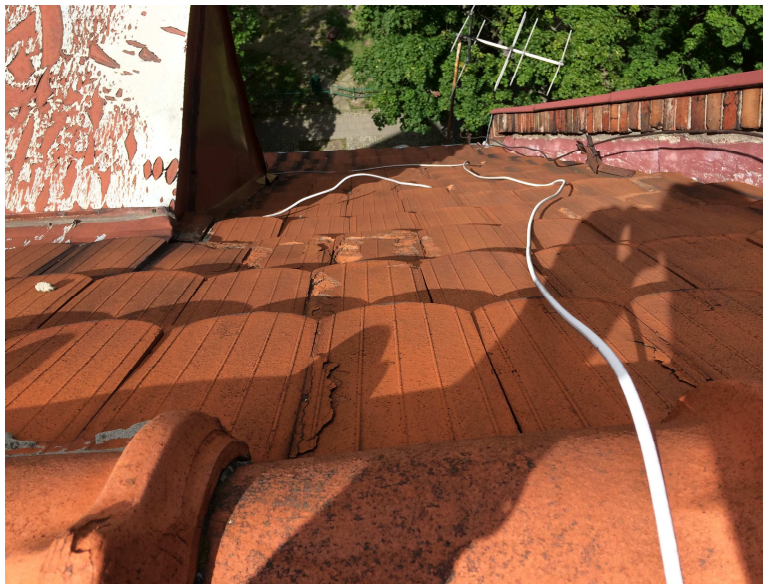
Rys. 13. Pokrycie ceramiczne znaczne zużyte w postaci silnych złuszczeń; widać leżące fragmenty dachówek na daszku płaskim nad lukarną, które mogą w każdej chwili spaść na ulice raniąc przechodniów
