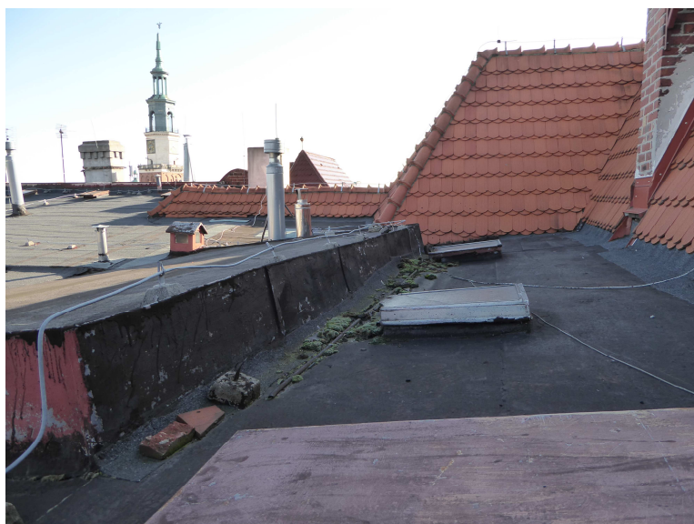
Rys. 14. Pokrycie papowe w stanie znacznego zużycia; ponadto widać ślady korozji biologicznej pokrycia w postaci mchu i luźne mocowania instalacji uziomu
