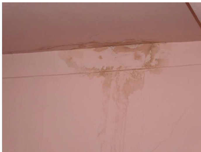
Rys. 4. Intensywny zaciek na poddaszu przed wejściem do mieszkania
