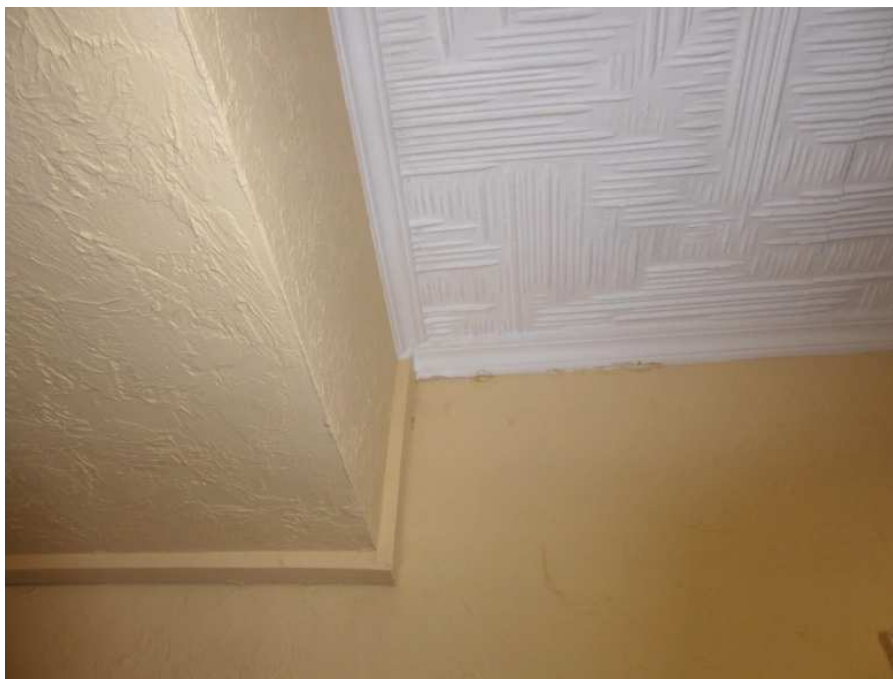
Rys. 11. Nieznaczące ślady zacieków w korytarzu mieszkania na ostatniej kondygnacji
