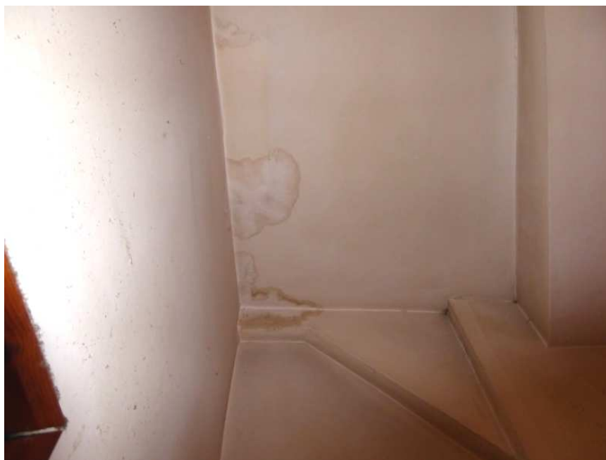
Rys. 8. Intensywne zacieki na suficie z silnymi śladami korozji w korytarzu mieszkania na poddaszu w budynku nr 8A
