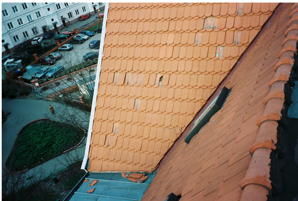
Rys. 12. Styk dachów frontowych od ul. Maształarskiej z pokryciem ceramicznym w stanie awaryjnym; widać leżące fragmenty dachówek na daszku płaskim, które mogą w każdej chwili spaść na ulicę raniąc przechodniów
