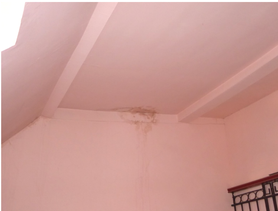
Rys. 9. Intensywny zaciek na styku sufitu i ściany z silnymi śladami korozji na klatce schodowej na poziomie ostatniej kondygnacji
