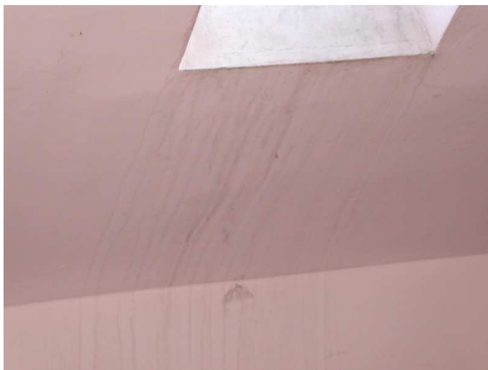
Rys. 10. Intensywny zaciek pod oknem dachowym na klatce schodowej ostatniej kondygnacji
