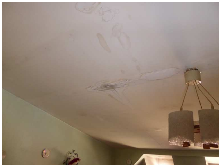
Rys. 7. Intensywne zacieki na suficie z silnymi śladami korozji w pokoju dziennym mieszkania na poddaszu w budynku nr 8A
