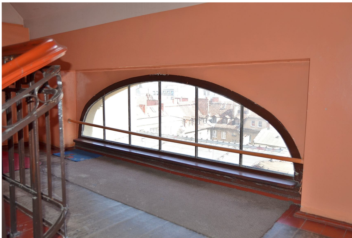
II. 15 Poznań, ul. Masztalarska 8 – Klatka schodowa „B” (południowo-zachodnia) - III i IV kondygnacja klatki schodowej – okno nr 3 (rewers)
