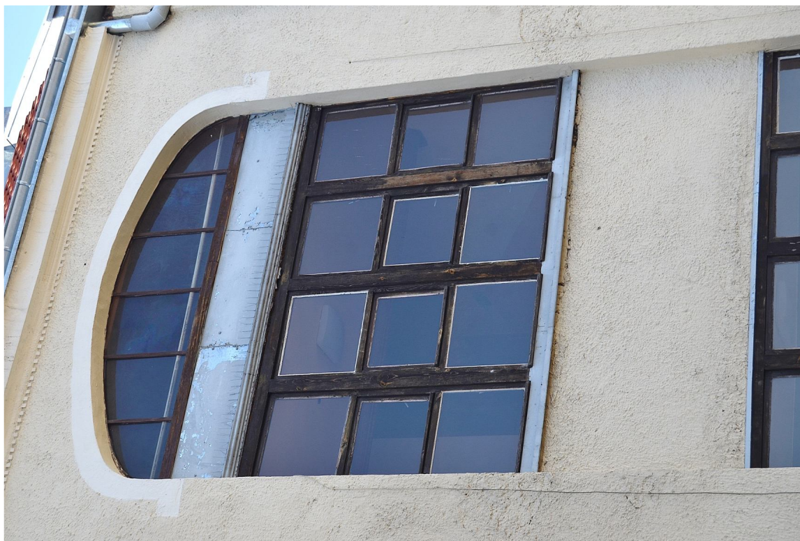
II. 13 Poznań, ul. Masztalarska 8 – Klatka schodowa „B” (południowo-zachodnia) - III i IV kondygnacja klatki schodowej – okno nr 3 (awers)
