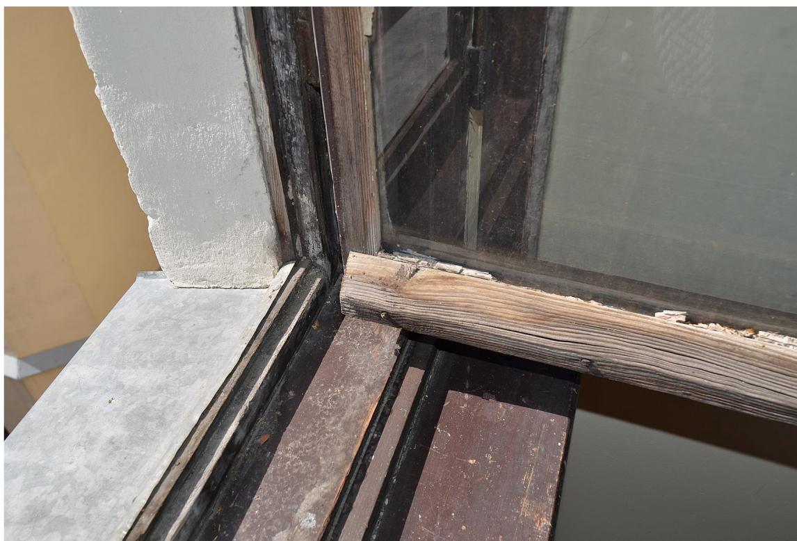
II. 32 Poznań, ul. Masztalarska 8 – Klatka schodowa „D” (północna) - widok na fragment stolarki okiennej (próg skrzynki, stojak oraz skrzydło okienne i parapety)
