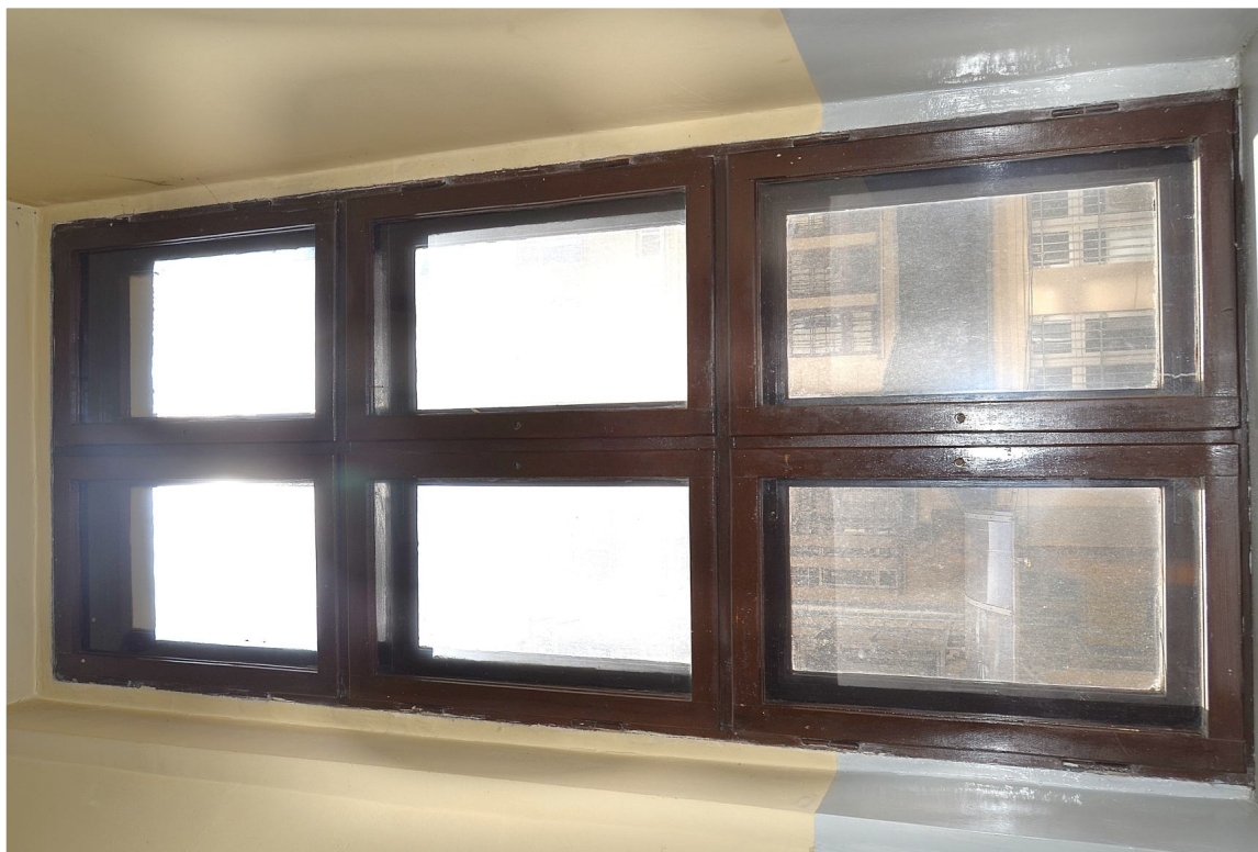
Il. 26 Poznań, ul. Masztalarska 8 – Klatka schodowa „D” (północna) - I kondygnacja klatki schodowej – okno nr 1 (rewers)
