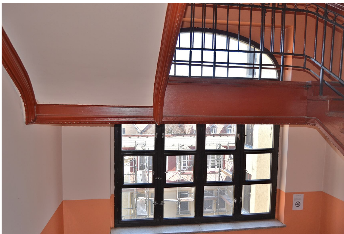
II. 14 Poznań, ul. Masztalarska 8 – Klatka schodowa „B” (południowo-zachodnia) - III i IV kondygnacja klatki schodowej – okno nr 3 (rewers)
